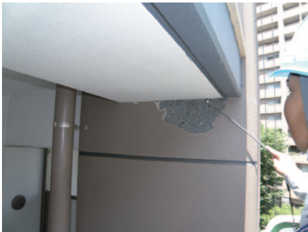
①柱梁取合い入隅のプレキャスト高強度コンクリートに発生した剥離欠損。大きさは様々だが欠損の個所数は各棟1000個所前後。
