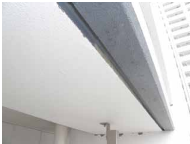
水切り内側の塗装忘れ。プレコンの素地のままで塗装されていない個所があった。
