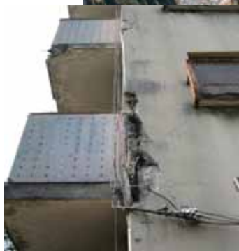
◀写真17 外壁のモルタル・コンクリートの剥離と鉄筋露出
