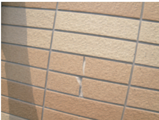
③梁外面の打込みタイル中央部のひび割れに沿った船底型の欠損。欠けたというより、弾け飛んだという印象。打込みのため、浮きの発生は無い。
