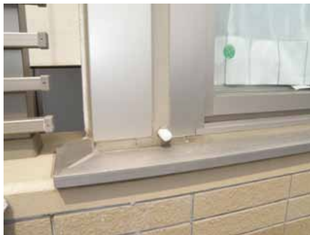
FIX窓シーリングの下部に設けられた水抜き穴。本来はパイプ設置のはずだが、ポリスチレンの発泡体が詰め込まれたまま。
