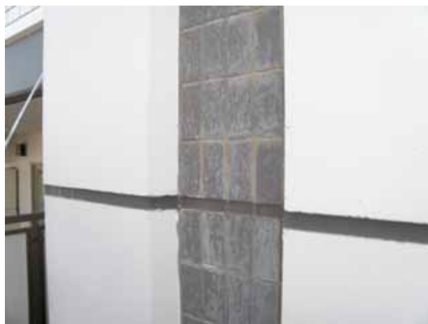
機械式継手に使用されたグラウトが溢れて流れた後の拭き取り忘れ。
