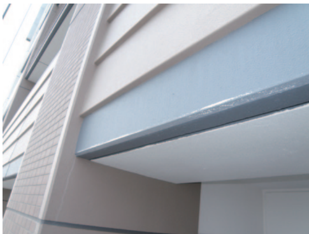
塗装の塗りムラ。下地色が露出したままの状態。
