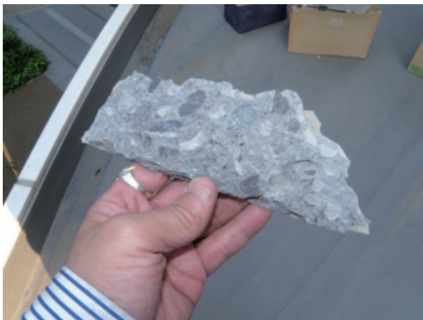
②剥離片。深さは10ミリ以下で骨材から割れていた。端部はかなり鋭く、素手で触ると切り傷が出来るといふ。この切片が地上に落下して事故にならなかったことが幸い。
