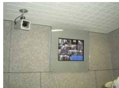
写真9 エントランスホールの防犯カメラ設置
