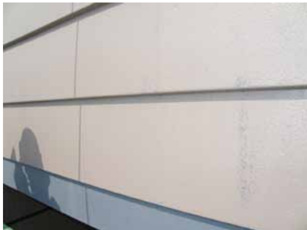
色の塗り間違い個所を塗り直した部分で、塗膜剥離を起こしている個所。
