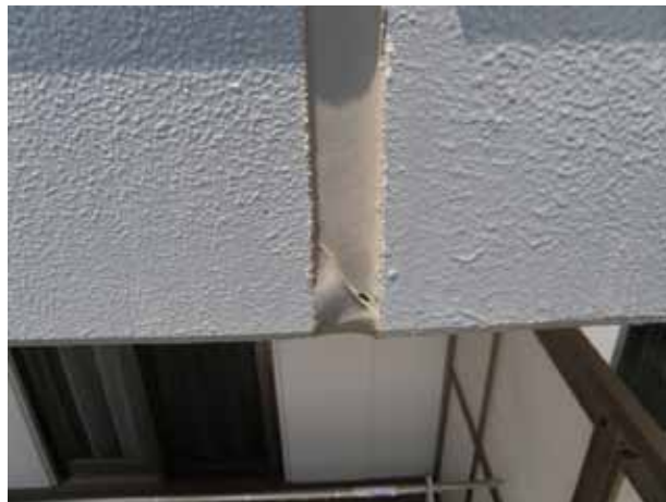
目地シーリングの継ぎ目部分に出来たピンホール。
