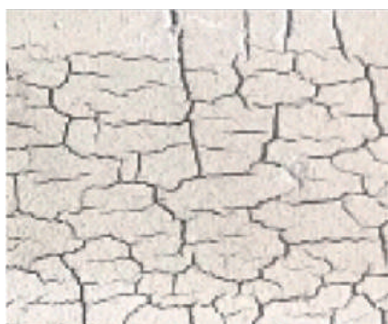
写真1 促進試験による劣化状況の例
