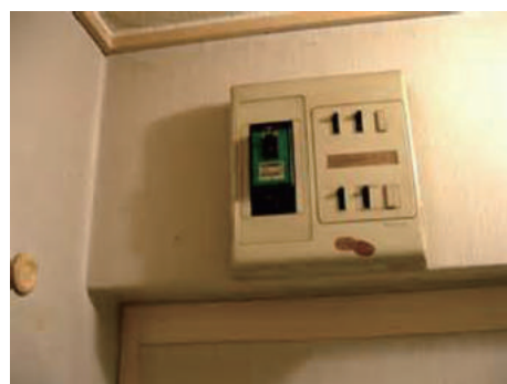
既存分電盤 (4回路の場合)
