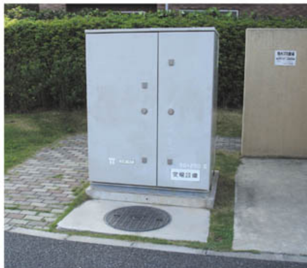
「集合住宅用変圧器」設置の例
