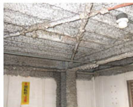
エレベーター機械室 吹付材 (飛散性アスベスト)
