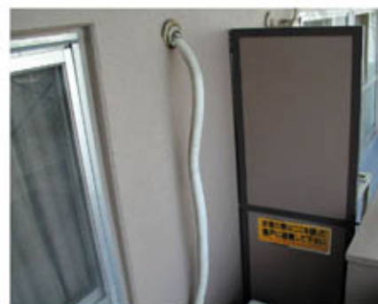
バルコニー パーテーション (非飛散性アスベスト)
