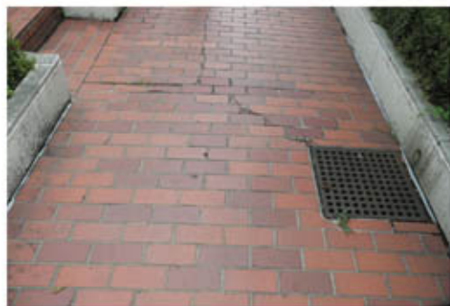
写真4 レンガタイル舗装のひび割れ、破損
