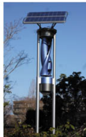
地域防災拠点の 太陽光発電+風力発電
