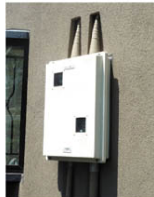
設備盤回りの断熱材切り欠き
