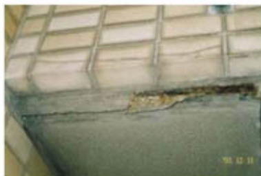
鉄筋露出・コンクリート剥落・ タイルひび割れ
