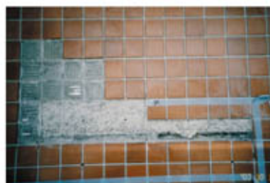
タイル浮き部を除去したところ
