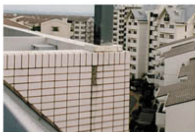
タイルがひび割れて3枚剥落
