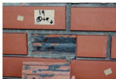
点状(1枚)浮きのレンガタイルを剥したところ(タイル裏が見えている)
