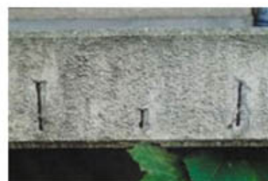
バルコニー鼻先の鉄筋露出
