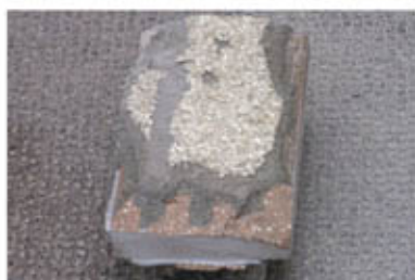
コンクリート補修モルタル部で剥がれたタイル
