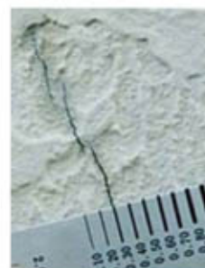
外壁ひび割れ0.3mm
