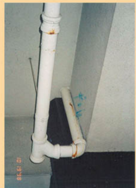
台所排水管の縦直管部でのピンホール漏水
