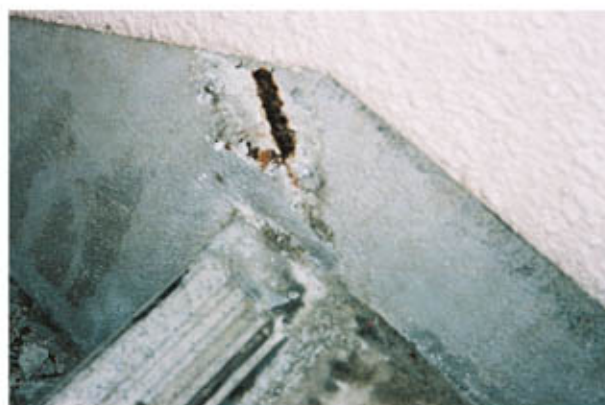
開放階段ササラ部分の鉄筋発錆
