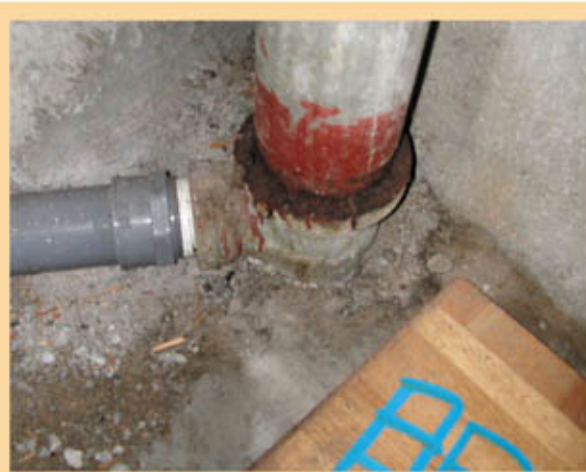
台所系排水管の継手ねじ部の傷み
