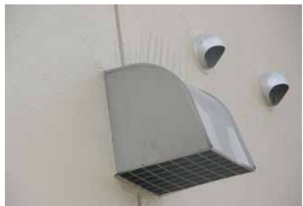
換気ダクトへ設置
