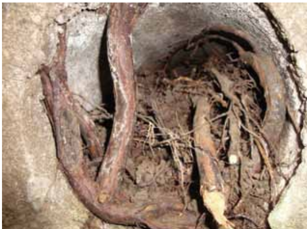
写真1 侵入根付着状況
