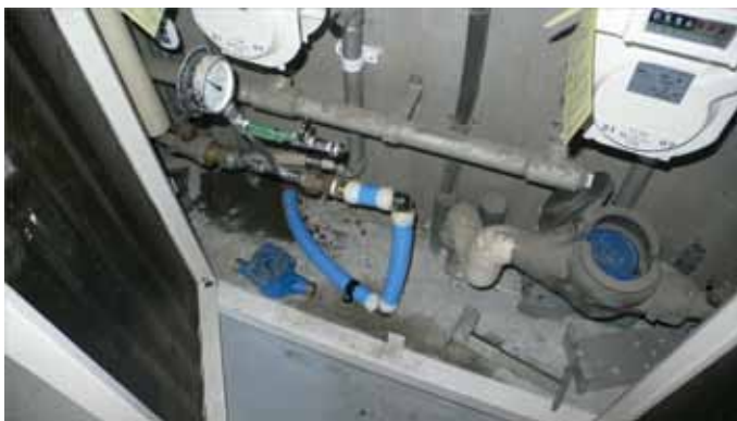
メーターボックス内の給水管。水道メーターより住戸側が専有配管となるが自己所有の意識は薄い。
