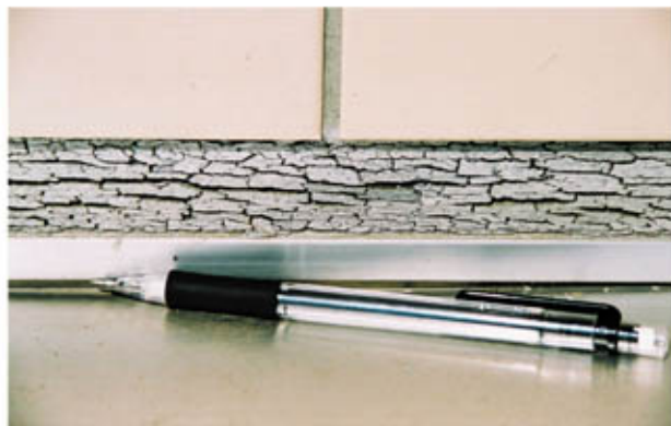
写真1 タイルとEXPJ金物との目地（一次シール）にポリウレタン系シーリング材が使用されていたため10年程度で積層状に劣化している。
