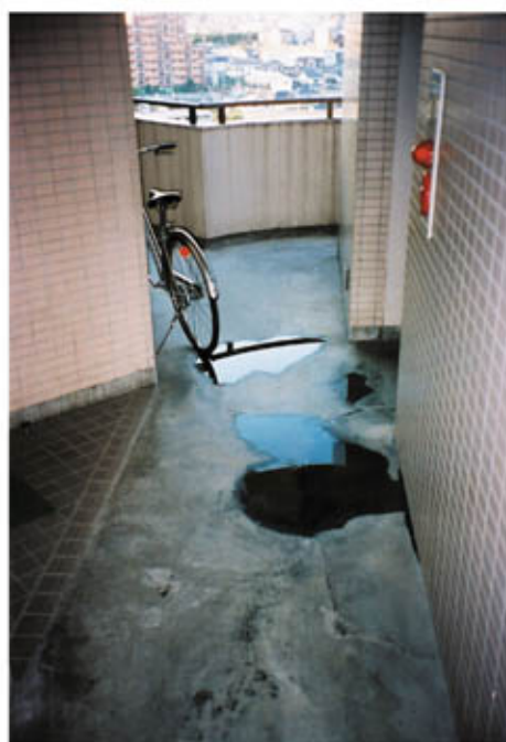
写真1 開放廊下の水たまり
