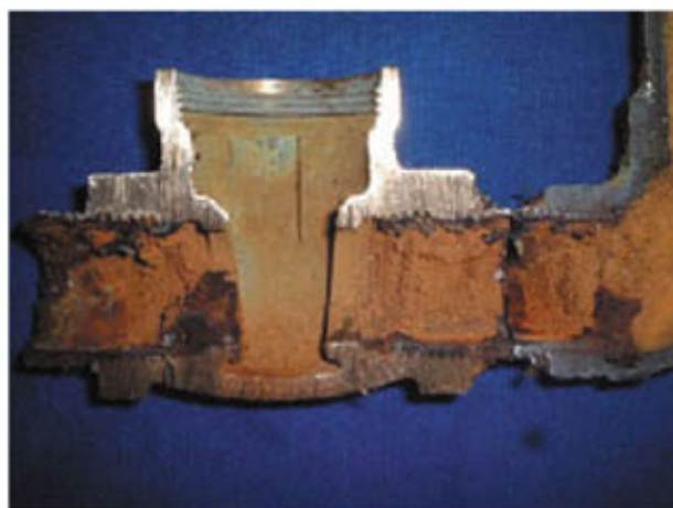
写真5 写真3の異種金属接続部の半割れ・錆除去後の欠損状況
