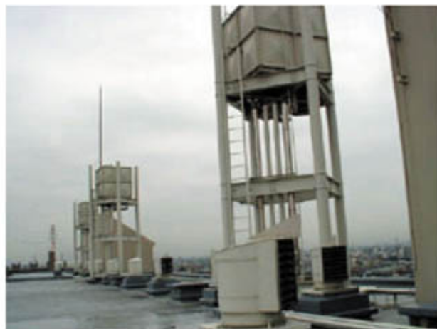
写真2 給水施設（高架水槽）
