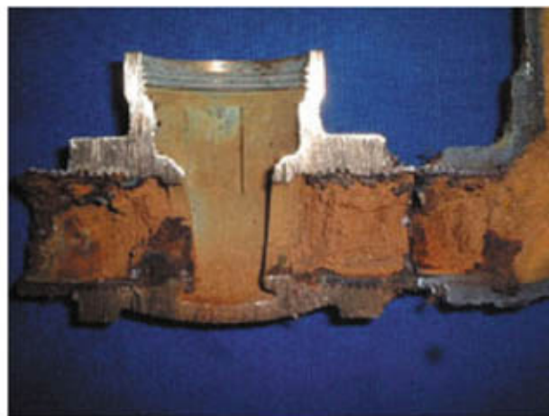
写真3 異種金属接続部腐食状況
