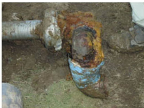
写真4 土中埋設管の樹脂コーティング継手部での電食による穴あき漏水
