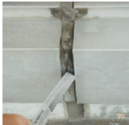
シーリング防水の故障例
