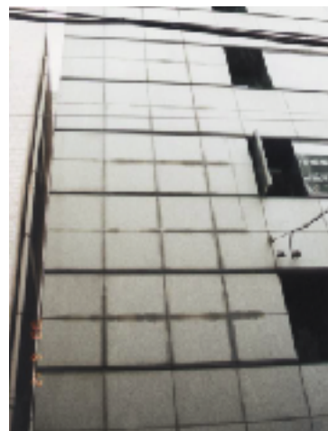
目地周辺の汚染(汚れは保証の対象外)
