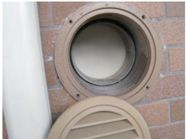
左写真部分を室外側から見たところ。壁紙で塞がれ、給気口を無くされてしまっていた
