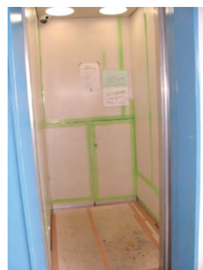
エレベーター内
