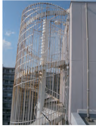
写真⑫ 螺旋階段の改修前の腐食劣化状況
