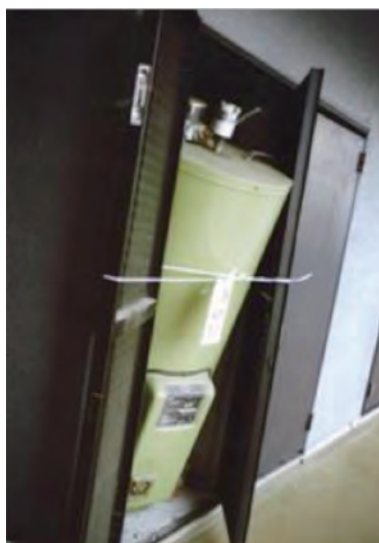
転倒した電気温水器
