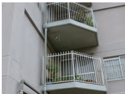
写真⑦ バルコニー手摺改修前の状況
