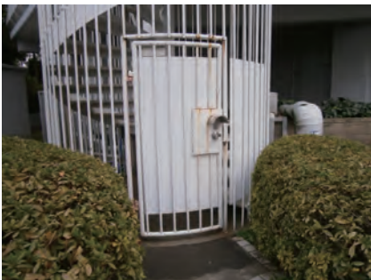
写真⑭ 螺旋階段 1 階の曲面入口扉改修前状況
