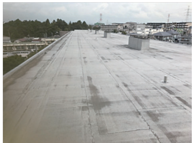
写真1 屋上アスファルト露出防水・保護塗料の劣化
