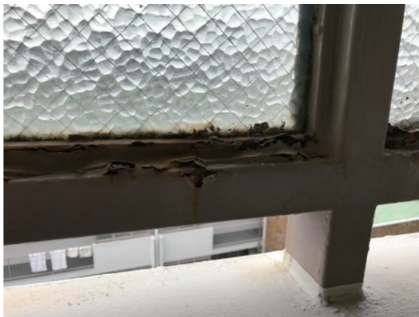
写真3 防風スクリーンの傷み
