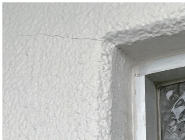
写真7 廊下外壁のひび割れ
