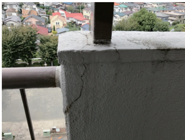
写真8 共用廊下手すりと防風スクリーン コンクリートの劣化
