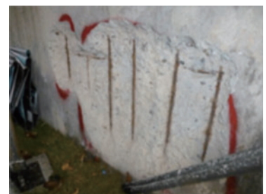
鉄筋爆裂の再発は躯体を傷める
