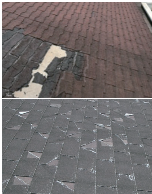
シングル葺部分飛散箇所
