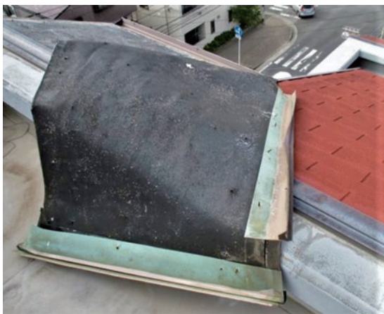
台風によるシングル屋根破損
