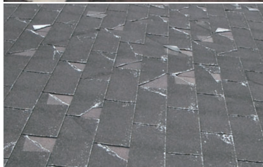
シングル葺部分飛散箇所
