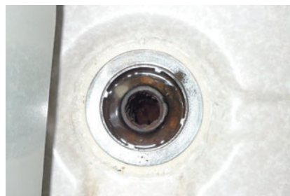
写真 8 ②トラップの腐蝕
