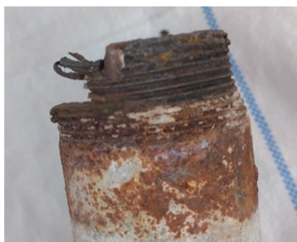
写真 4 ⑦トラップ接続部の腐蝕
