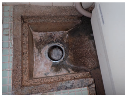
写真 1 エフロレッセンスの溶出
