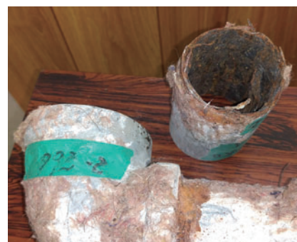
写真 6 ⑦トラップ接続部の腐蝕
