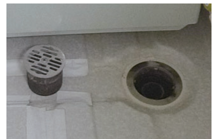
写真 9 ②トラップの腐蝕
