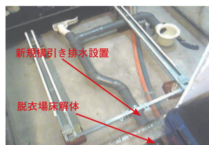
写真 16 洗い場排水管・給水給湯管
