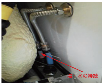
写真 18 給水・給湯管接続配管
