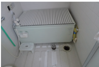
写真 7 ①防水パン保護塗装劣化
