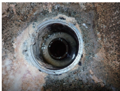
写真 2 エフロレッセンスの溜り
