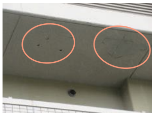
⑤3 既存塗膜剥がれ
