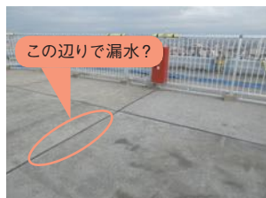
④④ 漏水報告箇所
