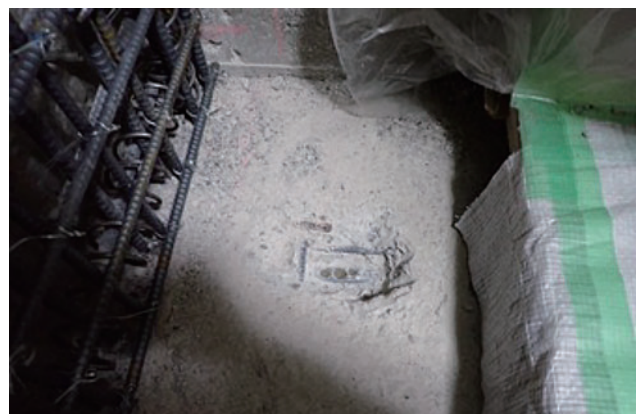
想定外位置にある電気配線管の損傷
