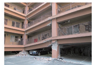
旧耐震基準のマンションは耐震診断を受け、耐震性が不足している場合は耐震改修しましょう。
