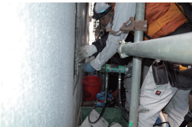
タイル、モルタルを油圧で剥離する試験施工 低騒音だったが費用がかかるため不採用となった
