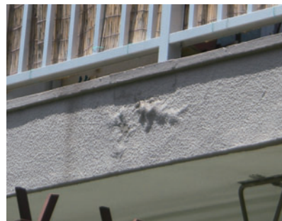
写真2 手すり支柱足元クラック状況
